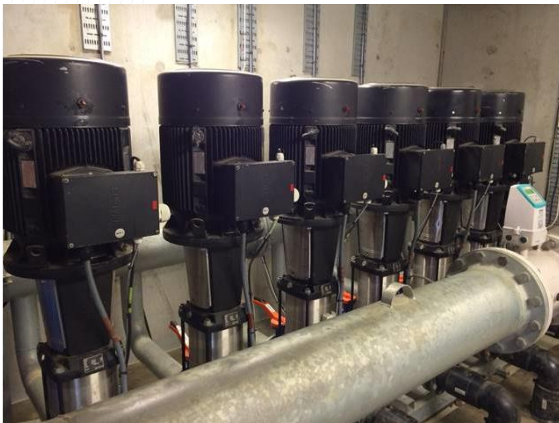
Figur 4.4: Pumperne i pumpehuse, der er tilknyttet vandingsanlægget
